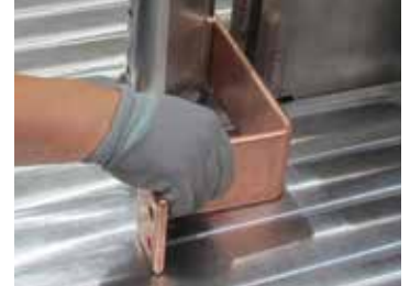
73 Surpilage automatique pour barres de cuivre Automatisch opnieuw buigen van koperstrip
