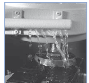
Refroidissement à l'eau
